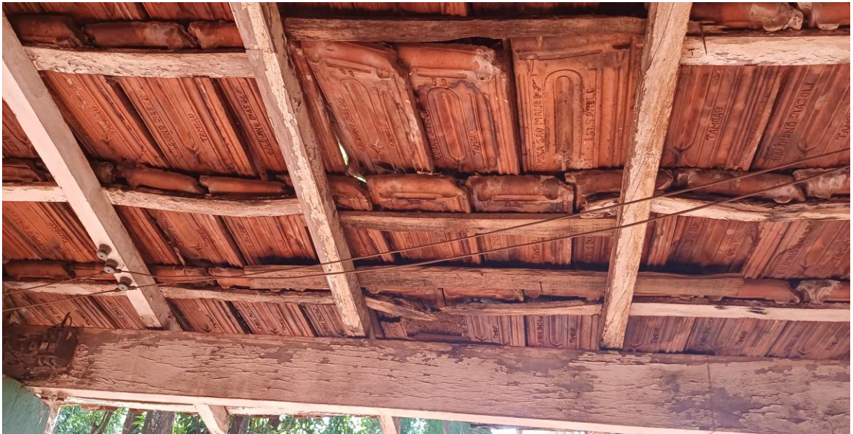
Figura 03 - Vista do local ilustrando cobertura do Kiosque onde necessita de reforma para gerar conforto e segurança no local.
