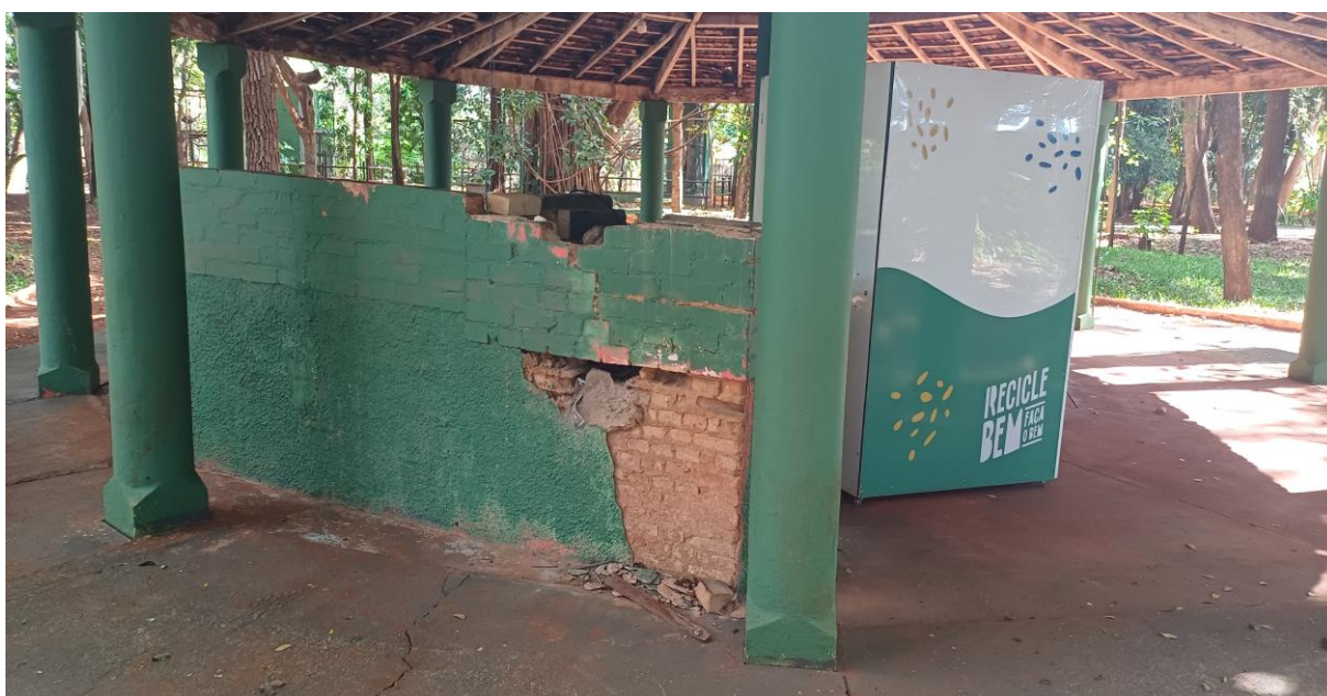
Figura 02 - Vista do local ilustrando o Kiosque do local, onde necessita restauração em sua estrutura em alvenaria, para gerar conforto aos frequentadores do Zoológico.
