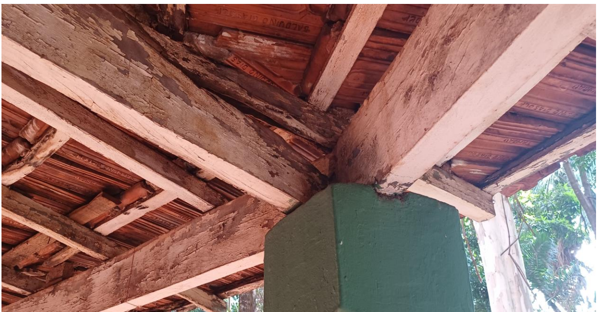
Figura 04 - Vista do local ilustrando estrutura precária na madeira, a qual faz parte da cobertura do Kiosque, onde necessita de reforma a cargo do Poder Público Municipal.
