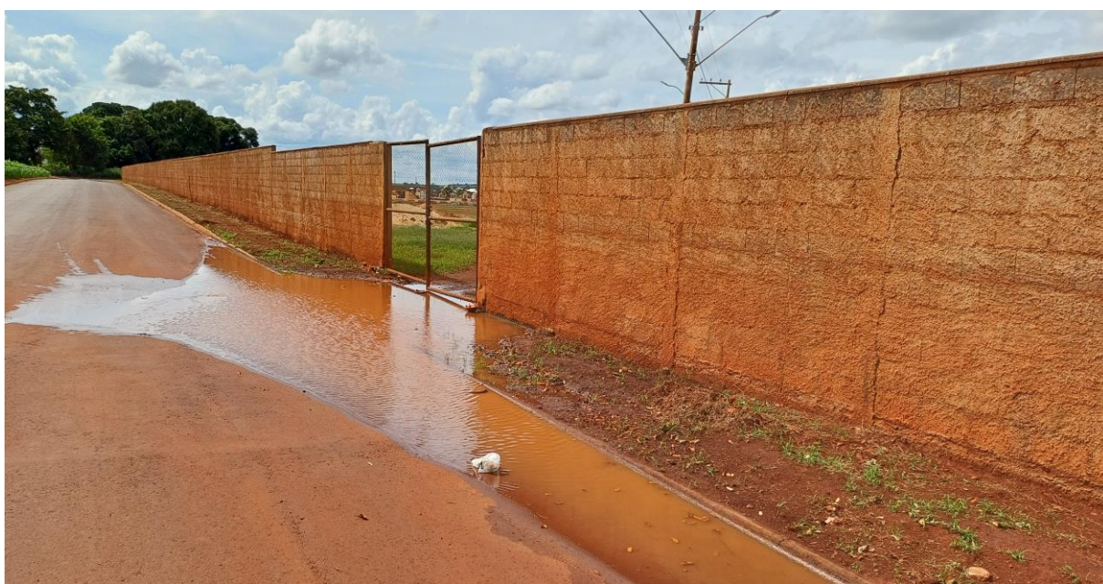
Figura 02 - Vista do local ilustrando acúmulo de águas pluvias, onde necessita de adequação/reparo a cargo do setor competente do nosso Poder Executivo local.
