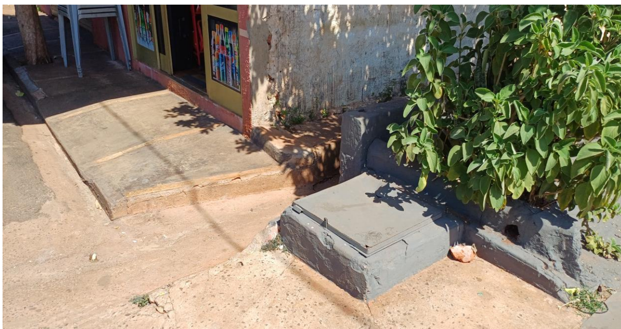
Figura 03 -. Vista da calçada pública necessitando adequação em seu final, para tornar o local mais seguro aos pedestres e demais pessoas que utilizam daquele ambiente público.
