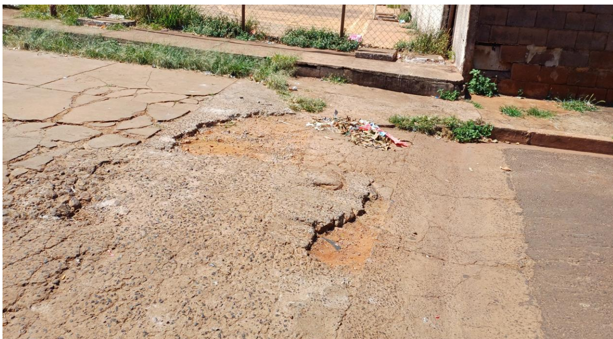
Figura 04 -. Vista da via pública cujo trecho destinado ao tráfego de veículo apresenta danos estruturais, o que gera insegurança aos que lá transitam.
