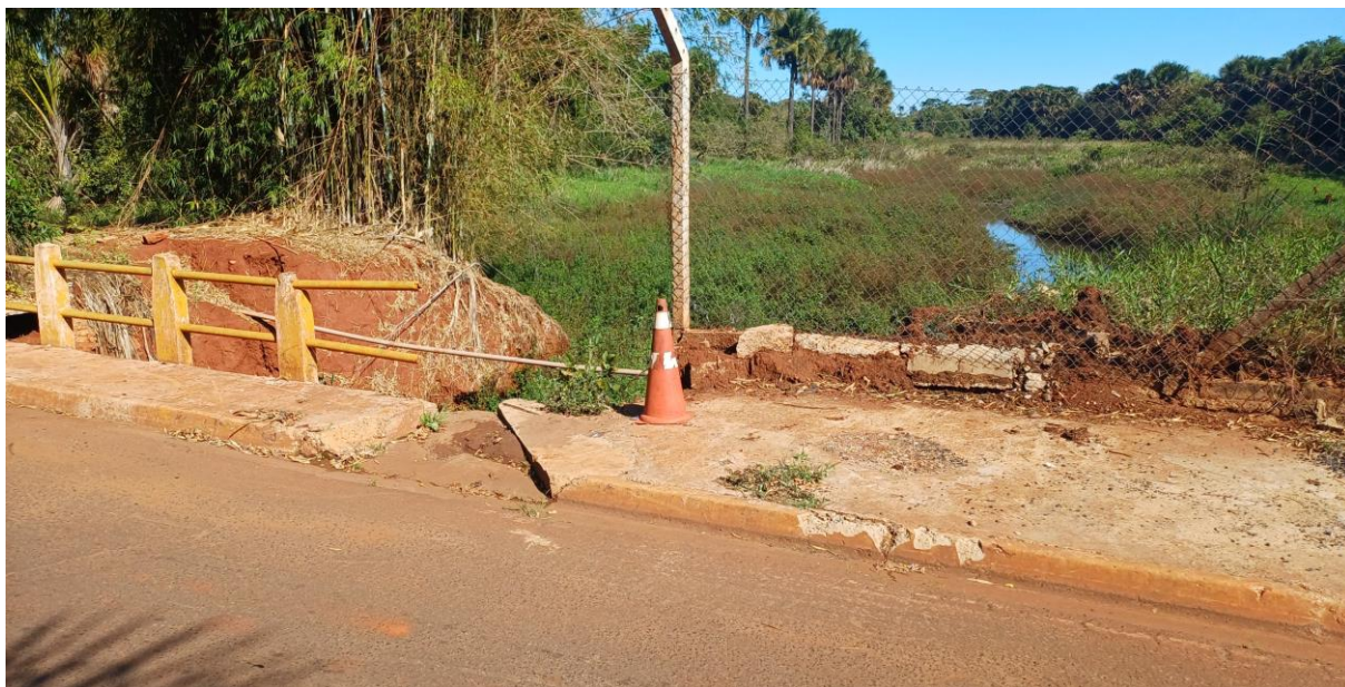
Figura 02 -. Vista do local ilustrando a lateral direita da ponte sobre o corrego das Antas, onde há a necessidade de reparos a cargo do Poder Público Municipal.
