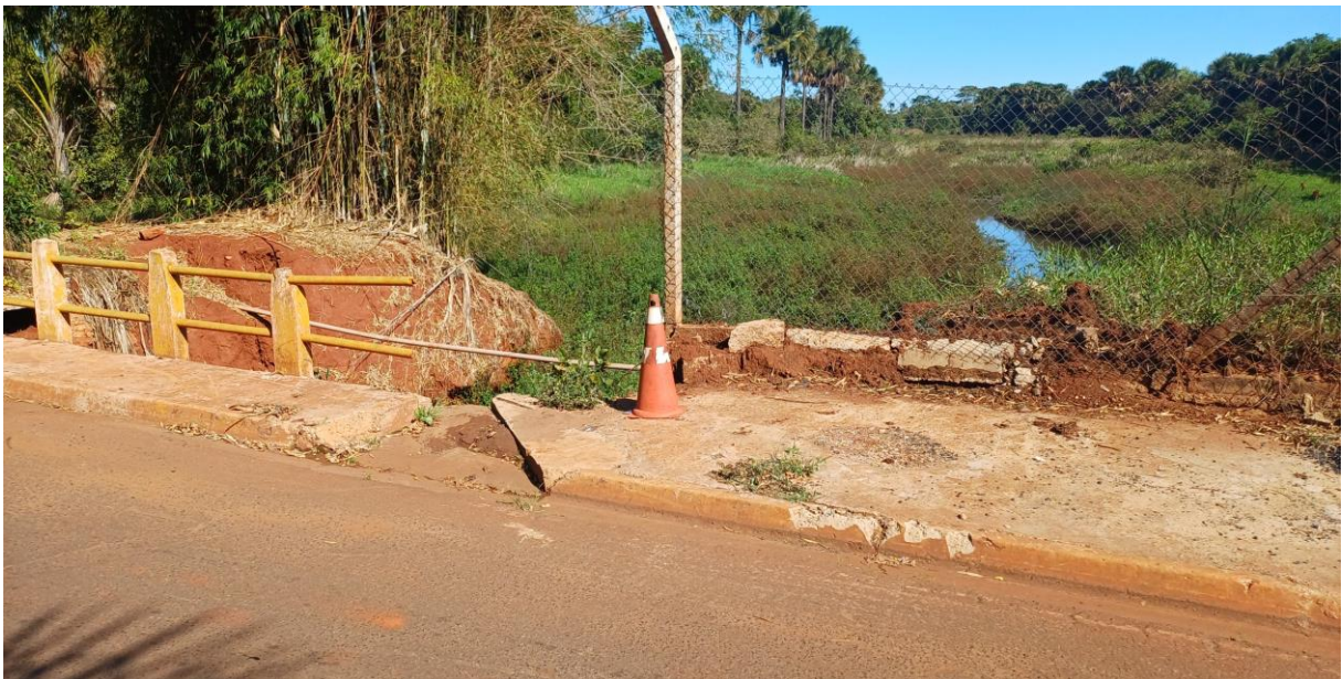
Figura 02 -. Vista do local ilustrando a lateral direita da ponte sobre o corrego das Antas, onde há a necessidade de reparos a cargo do Poder Público Municipal.
