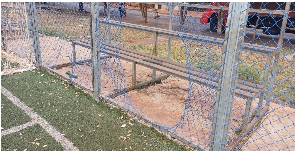
Figura 03 -. Vista do local ilustrando alambrado danificado, necessitando de reparo para oferecer mais conforto aos frequentadores para prática esportiva.
