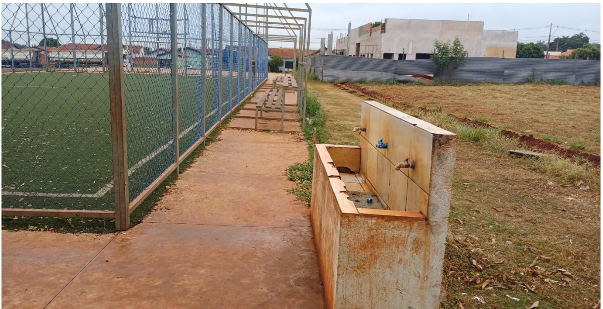
Figura 01 -. Vista do local ilustrando bebedouro d'água destinado ao público frequentador da Arena e nossa população, tal em estado de uso precário.
