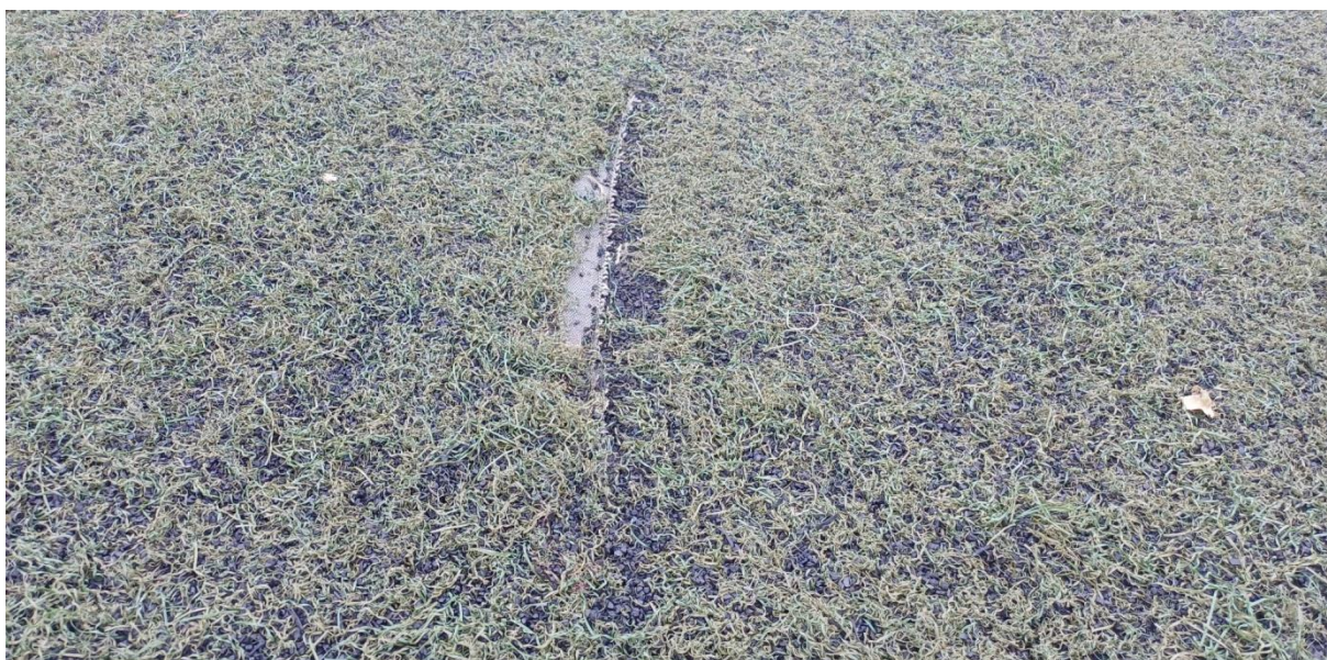
Figura 04 -. Vista do local destacando a grama sintética que necessita de manutenção para tornar o ambiente mais seguro para os que buscam lazer e atividades esportivas.
