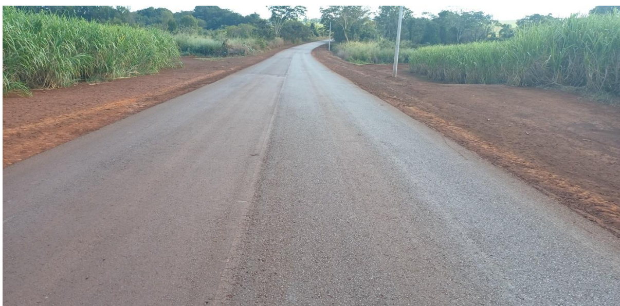
Figura 02 -. Vista do local ilustrando a necessidade de sinalização de solo e outras para gerar mais segurança aos que utilizam quando dos deslocamentos para exercer suas atividades.
