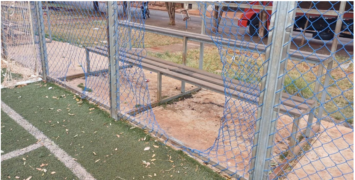
Figura 03 -. Vista do local ilustrando alambrado danificado, necessitando de reparo para oferecer mais conforto aos frequentadores para prática esportiva.
