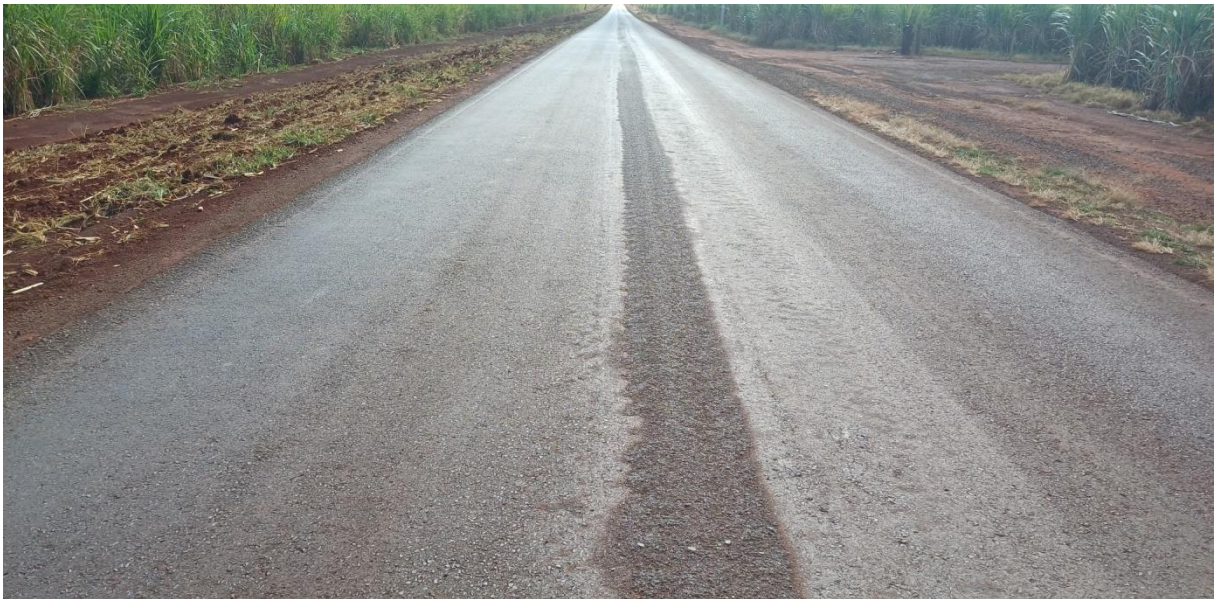
Figura 03 -. Vista do local ilustrando ausência de sinalizações de solo, o que gera insegurança aos que lá transitam em especial no período noturno e em épocas do período das chuvas.
