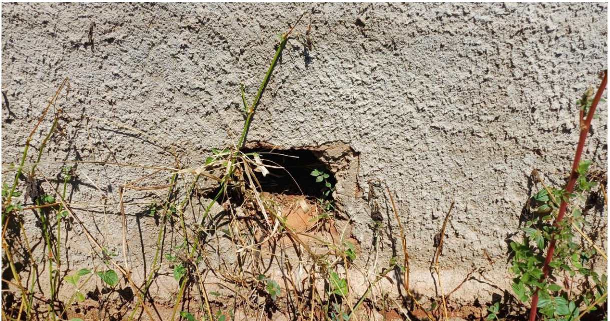
Figura 04 -.Vista do local onde verifica-se outro ponto, na parte inferior do muro que necessita de reparo, para tornar o local mais seguro a cargo da Autarquia e do Poder Executivo.
