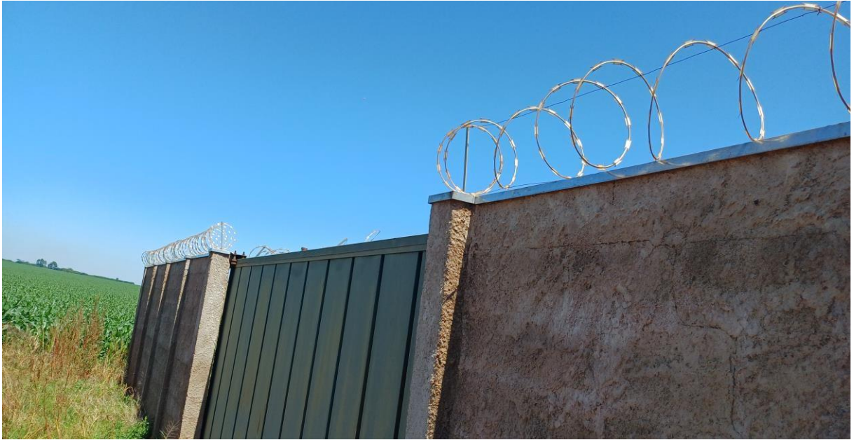
Figura 01 -. Vista do local ilustrando um dos portões de acesso ao imóvel, em especial em sua parte superior o tombamento da concertina / cerca cortante para aquele interior.
