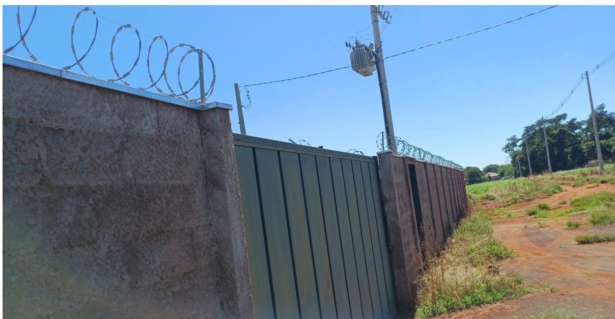
Figura 02 -. Vista do local por outro ângulo, da parte superior de um portão de acesso ao interior do local, o qual necessita de reparo e por tratar-se abastecimento de água a nossa população.
