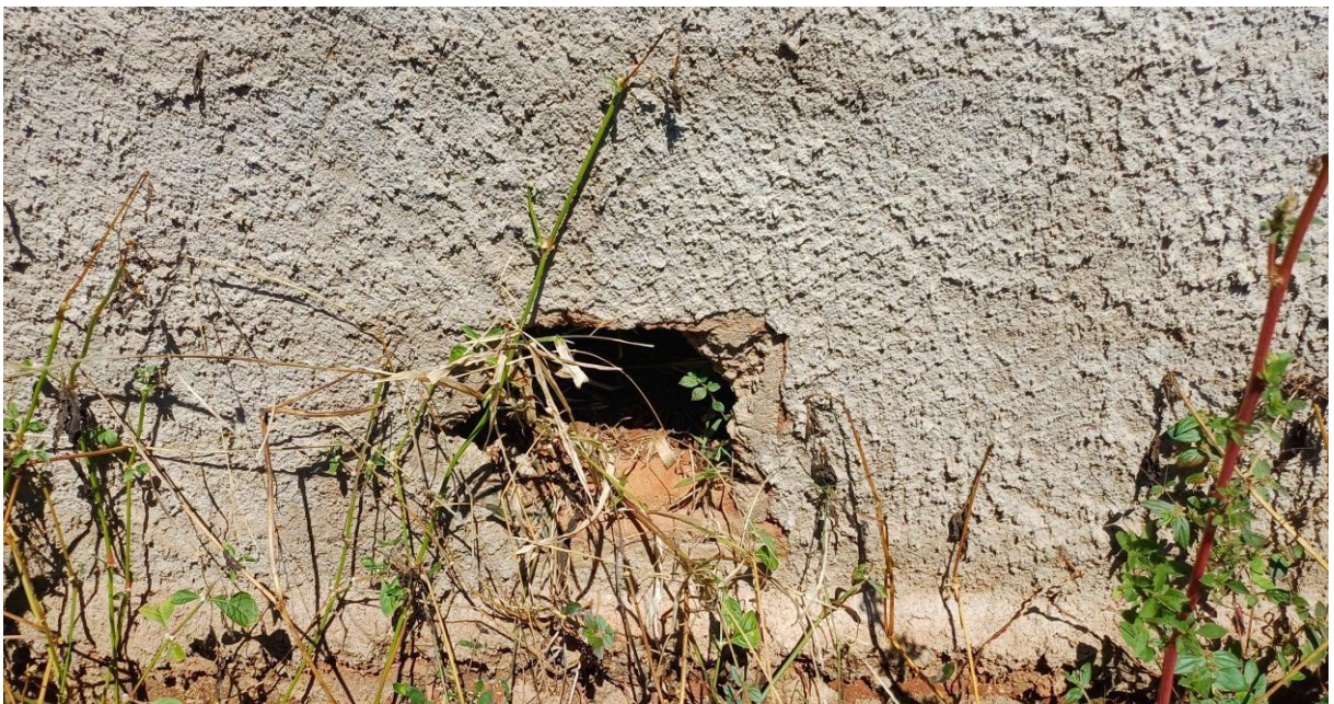
Figura 04 -.Vista do local onde verifica-se outro ponto, na parte inferior do muro que necessita de reparo, para tornar o local mais seguro a cargo da Autarquia e do Poder Executivo.
