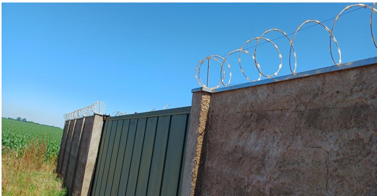
Figura 01 -. Vista do local ilustrando um dos portões de acesso ao imóvel, em especial em sua parte superior o tombamento da concertina / cerca cortante para aquele interior.
