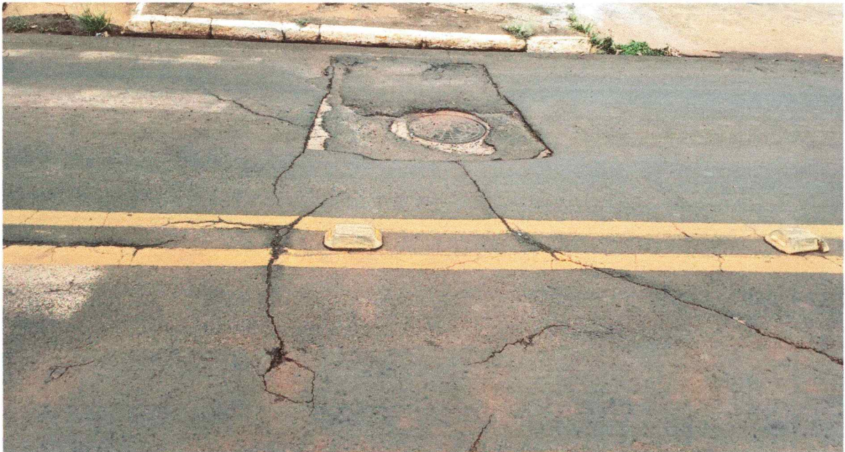
Figura 03 -. Vista do local ilustrando um bueiro com fisuras na camada asfáltica, o que necessita de uma avaliação para preservar o local seguro.
