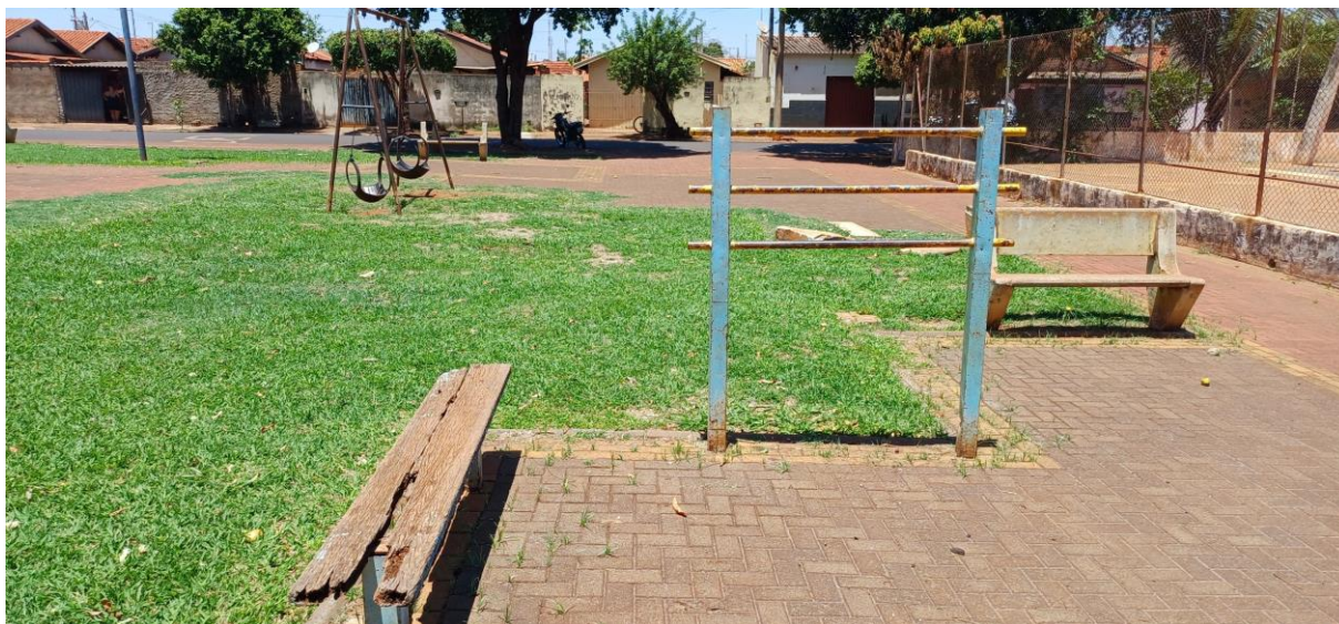
Figura 01 - Vista do local ilustrando banco em madeira e concreto que necessitam de reparos e brinquedos em numeros insuficientes, disponiveis as crianças e adolescentes que lá frequentam.
