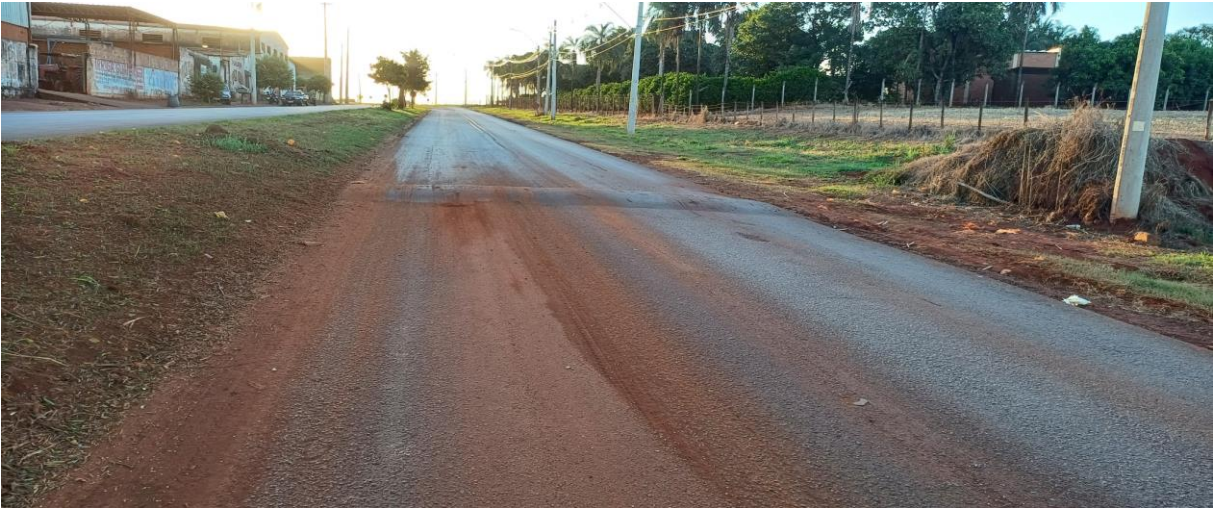
Figura 01 - Vista do local ilustrando redutor de velocidade - “Lombada” onde visualizamos ausência de pintura e placa indicativa.
