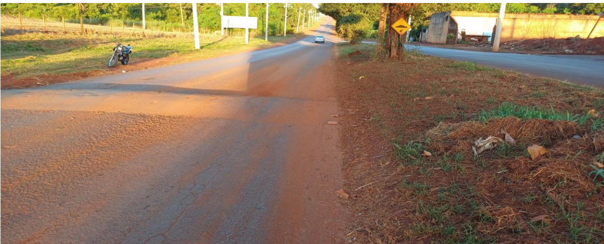
Figura 02 - Vista do local ilustrando redutor de velocidade, onde necessita de indicações para gerar mais segurança onde a placa de sinalização esta após o obstaculo ao solo e apodiada a uma árvore.
