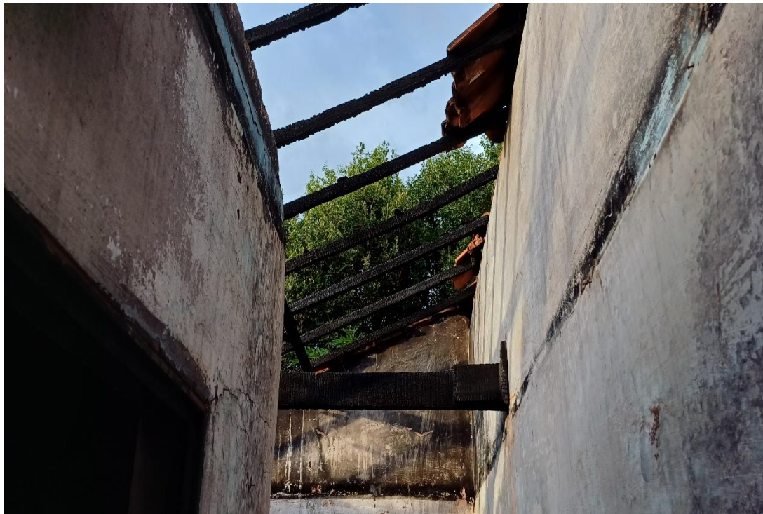
Figura 01 - Vista do local ilustrando estrutura do telhado de um imóvel, onde ocorreu incêndio cuja causa esta sendo investigada.
